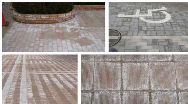
エフロレッセンスの発生事例
